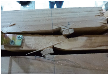
解体後・NO.3の車知の状況
