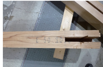
解体後・NO.1の梁の割裂
