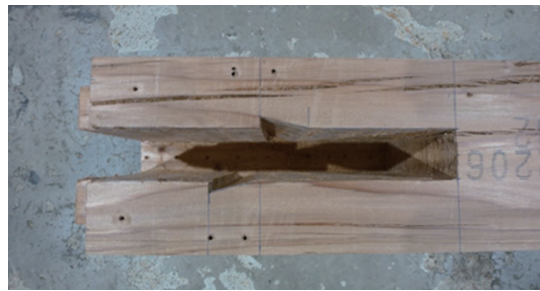
解体後・NO1 の女木の状況
