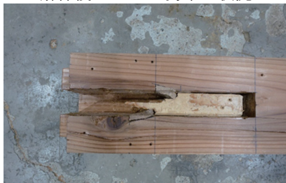
解体後・NO2 の破壊性状
