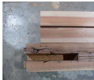
解体後・NO1 の女木の状況
