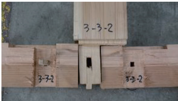
解体後・NO.2 の接合部の様子
