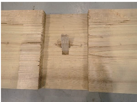
解体後・NO.3 の曲げ折れた込み栓とめり込み跡
