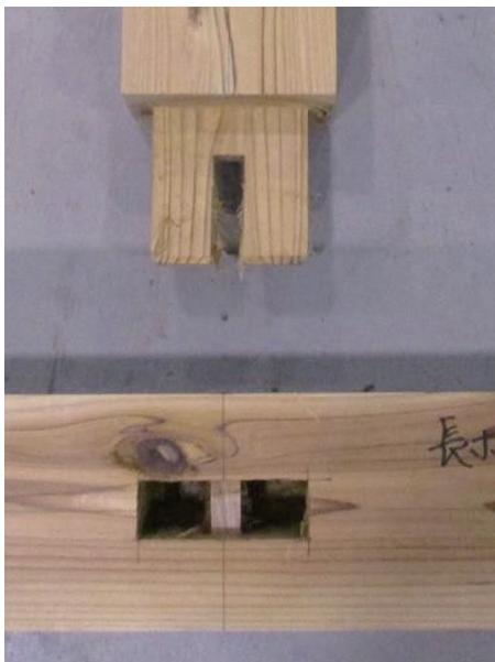
解体後・NO.1 ほぞのせん断破壊と残った込み栓
