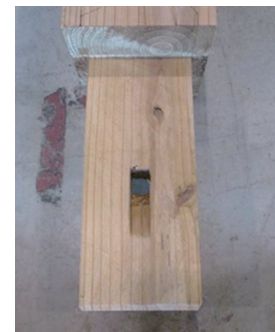
解体後・NO.3 込み栓に よるほぞのめり込み跡
