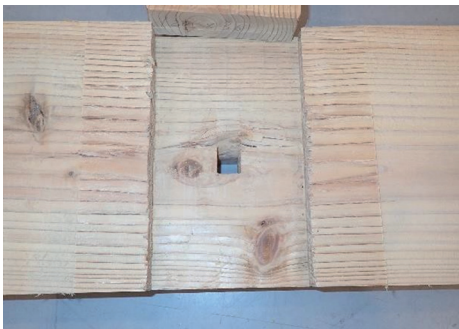
解体後・NO.1 の込み栓のめり込み跡
